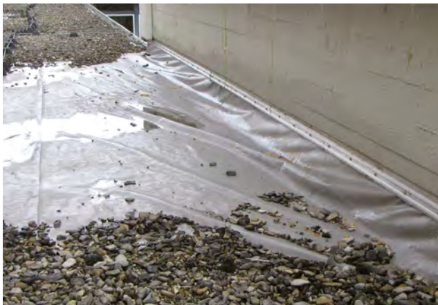
Faltenbildung und Verschiebung der Abdichtung bei fehlender Randfixierung
